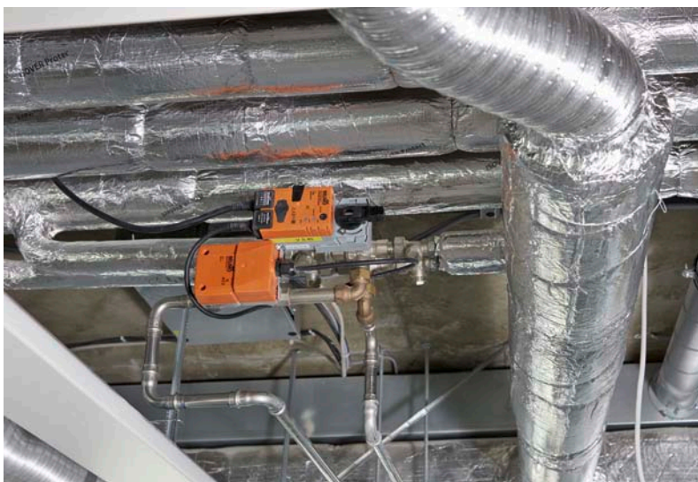
Die in der Decke eingebauten 6-Wege-Zonenventile regeln den Durchfluss von Warm- und Kaltwasser.
